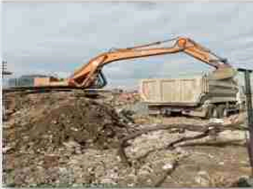
Yusuhoçuk Mahallesi Deprem Hasarı Evlerin Yıkımı
